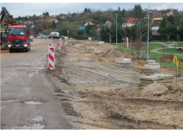
Kanalizacja jest częścią tej inwestycji
