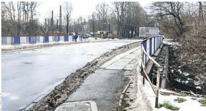
Kierowcy i piesi od dawna narzekają na kiepski stan wiaduktu
