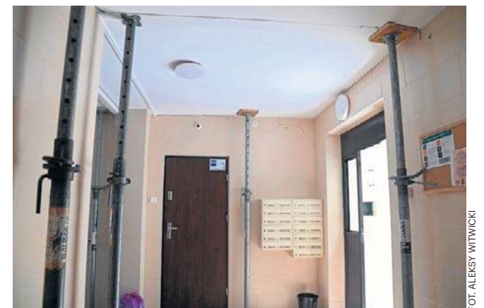
Tak wyglądają spęknięcia w bloku przy ulicy Hirszfelda
