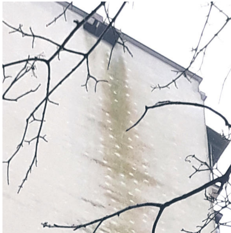
Zacieki na wieżowcu
