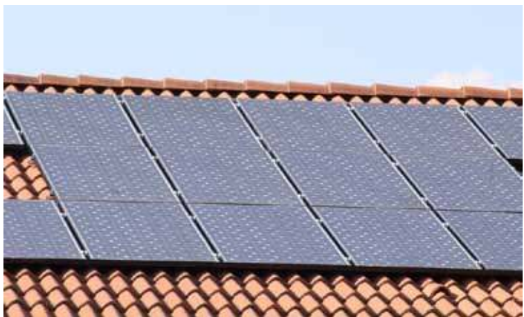
Panele fotowoltaiczne na jednym z dachów
