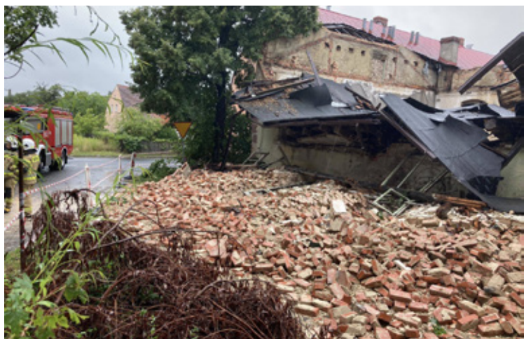
Zawalony budynek przy ulicy Urazkiej
