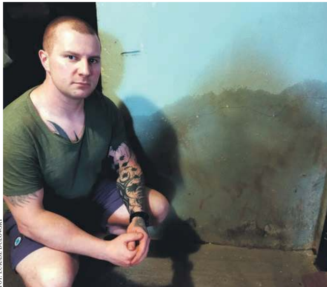
Miłosz Podgajny pokazuje zawilgocone ściany na parterze
