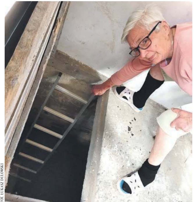
Janina Drabik mierzy drabiną poziom wody w piwnicy
