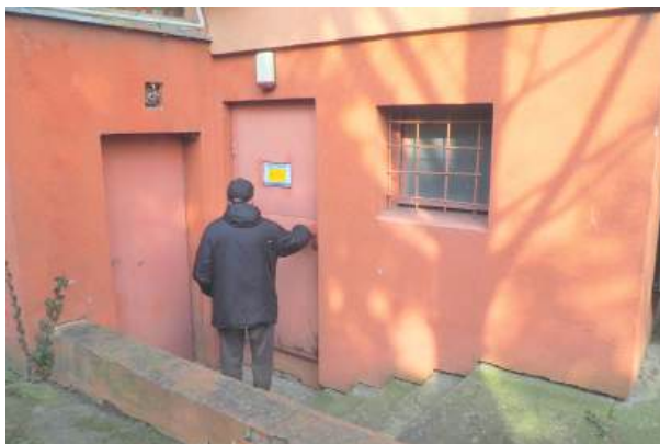
Spór dotyczył pomieszczenia kotłowni, znajdującego się na kondygnacji -1 budynku nr 20 przy ul. Grota-Roweckiego w Strzelinie
