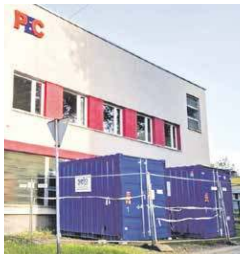
Kotłownia kontenerowa w Szombierkach
