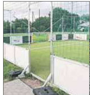
Wyrwana furtka w ogrodzeniu golboxa to tylko jedno z uszkodzeń konstrukcji
