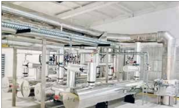
Oficjalnie nowa elektrociepłownia została otwarta w ubiegłym tygodniu
