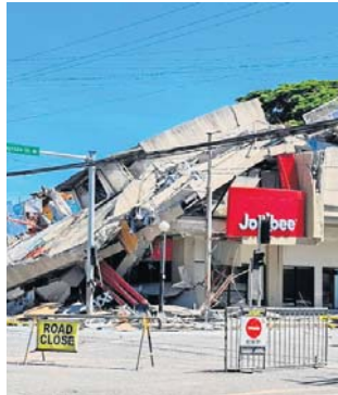
Trzęsienie ziemi nawiedziło południowe Filipiny. Uszkodzony budynek w General Santos
