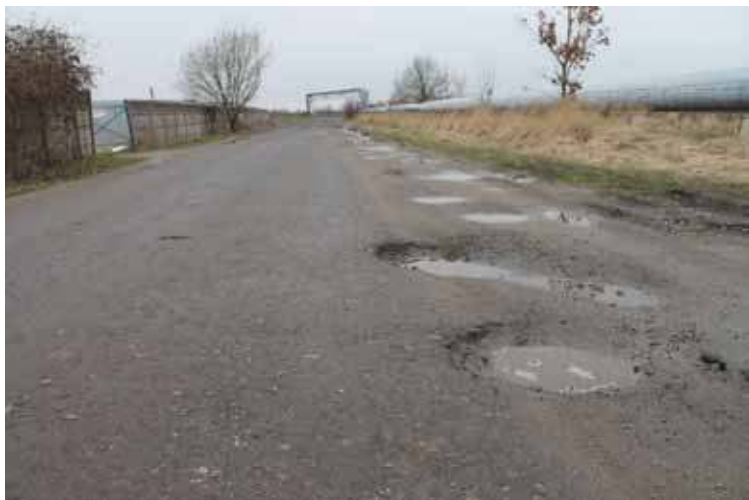
Dziury są miejscami bardzo głębokie
