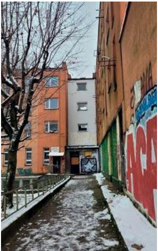
Czy ten budynek socjalny w Górcie na pewno nadaje się do rozbioru?
