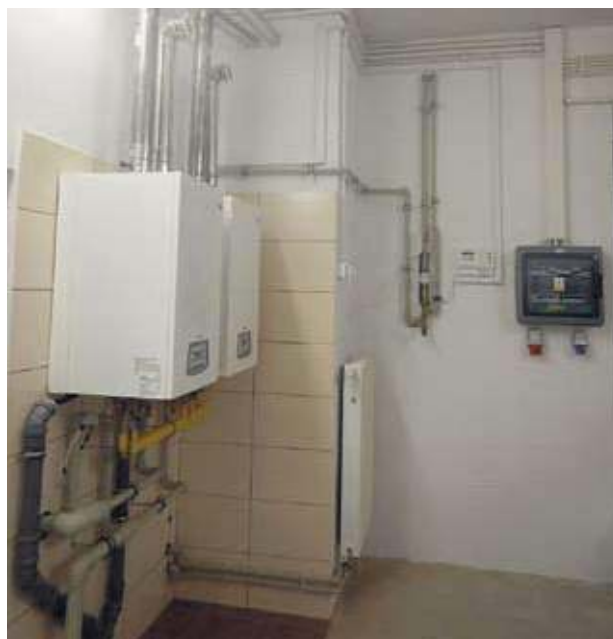
Rys.2. Kotłownia po modernizacji. Listopad 2018 roku
