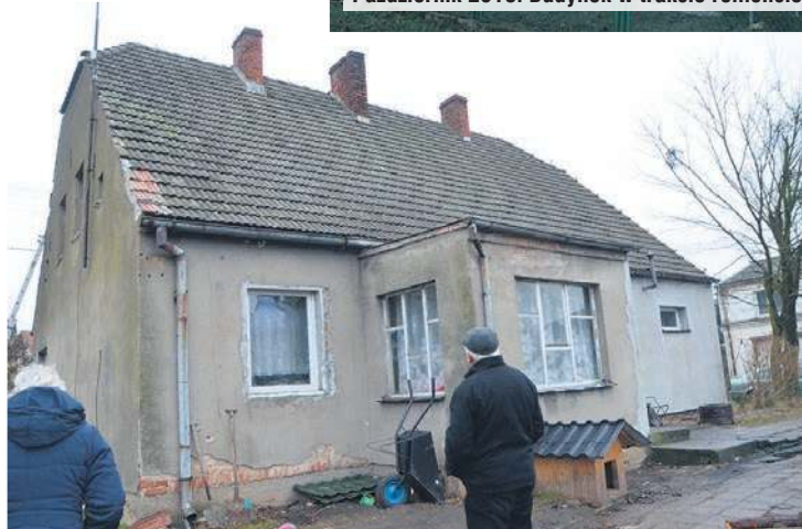
Marzec 2018. Wizja lokalna budynku komunalnego przy Okrężnej 16a i widok na stary, uszkodzony dach. Fot. Iz
