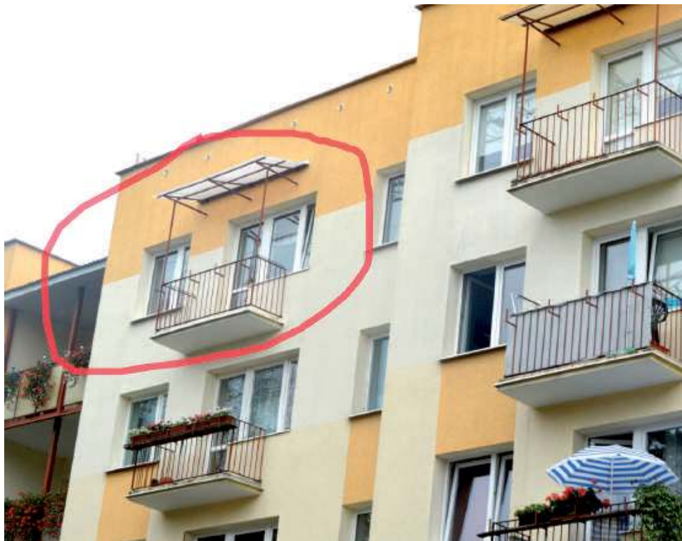
Olbrzymi dźwig, który stoi na placu budowy uszkodził mieszkańcom dach balkonu i kawałek ściany. Robotnicy naprawili szkodę w ciągu tygodnia
