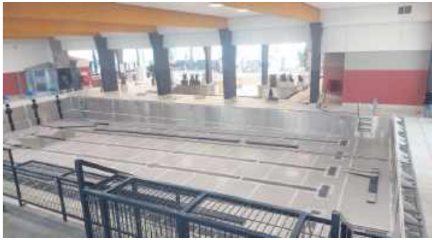
Podczas testowego napełniania niecki basenowej wodą, konstrukcja nie wytrzymała.
