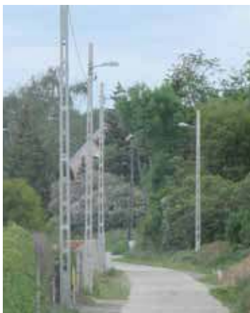
Ul. Topolowa, lampy - inwestycja zaczęta w 2018, miała być dokończona w 2019, a jest koniec 2020.
