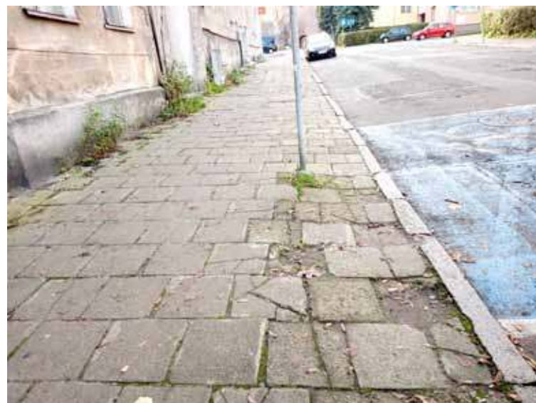
Stan chodnika jest zły m.in. przy miejscu dla niepełnosprawnych
