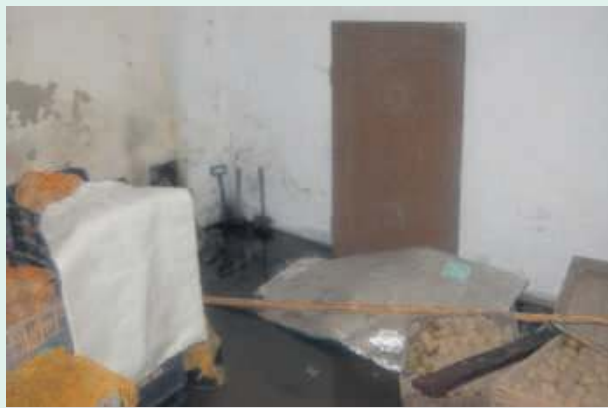
Woda nie oszczędziła piwnicy jednej z mieszanek
