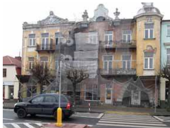
Obiekt wymaga szybkiego remontu
