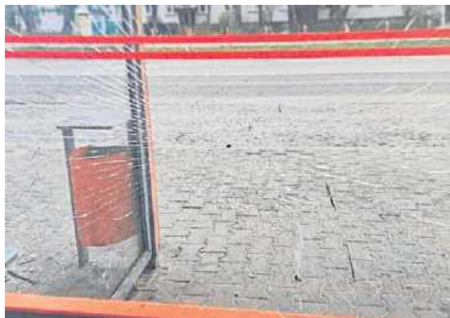
Uszkodzona szyba na przystanku przy ulicy Iłżeckiej w Ostrowcu Świętokrzyskim.
