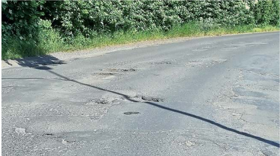
Na ul. Metalowej dziura za dziurą...
