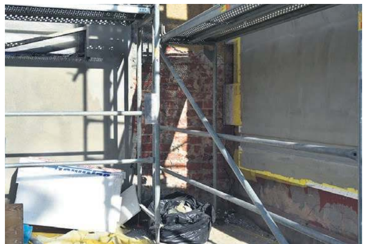
W głębi fragment średniowiecznego muru obronnego, który czeka na renowację.
