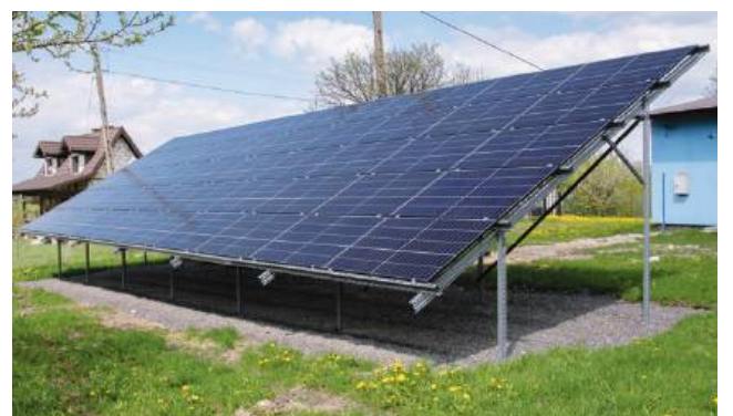
Instalacja fotowoltaiczna na ujęciu wody w Lipowcu.
