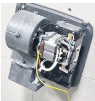
Uszkodzona została elektryczna suszarka do rąk.
