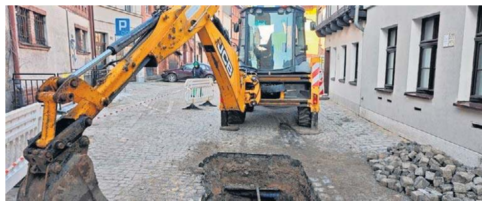
Usterka przyłącza przy ulicy Podmurnej została na szczęście szybko usunięta
