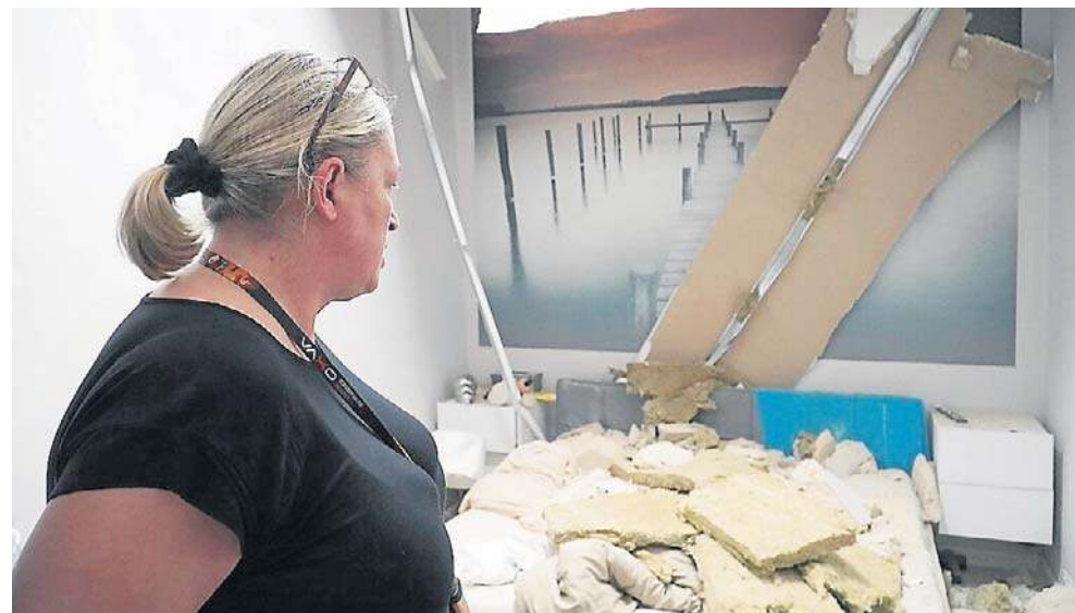
W sypialni mieszkańców łódzkiej kamienicy przy ul. Kilińskiego zawalił się strop
