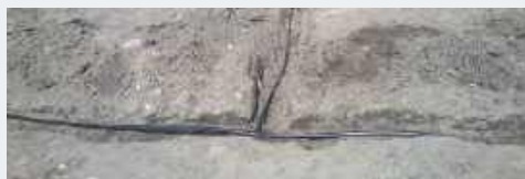
📍 Przed tarasem, na trawniku, biegną rurki rozprzodkujące 3/4 cala.
