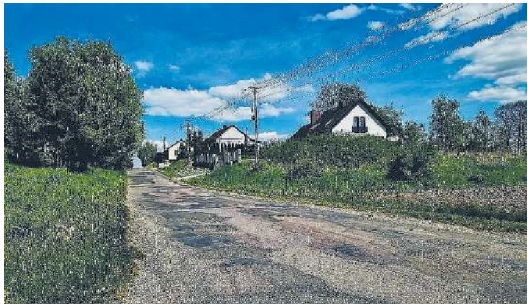
Droga do Niemienic nieprędko doczeka się remontu
