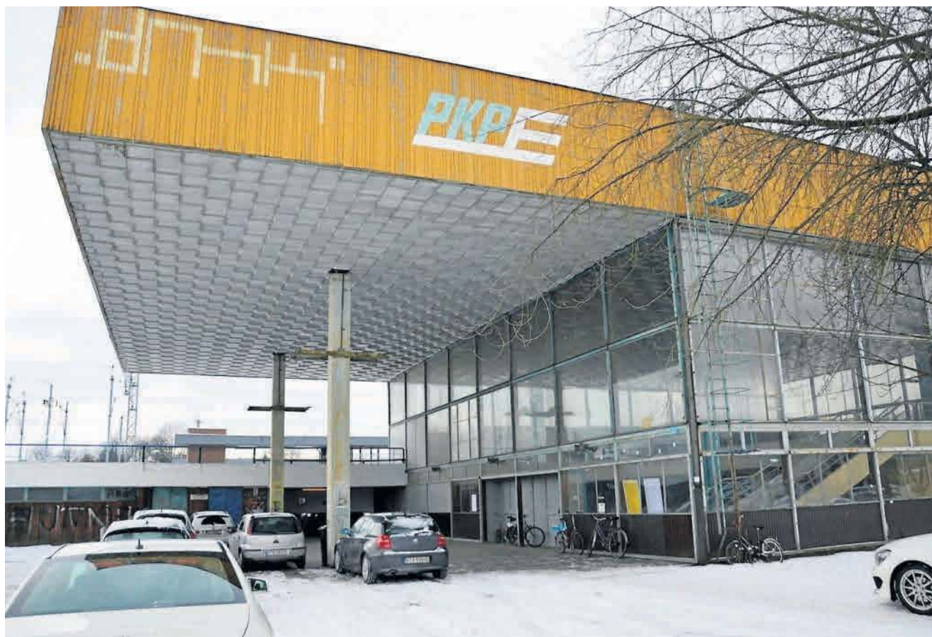
Dworzec w Mościcach od 2012 roku jest zamknięty na cztery spusty i niszczeje. Podróżni nie mogą z niego korzystać
