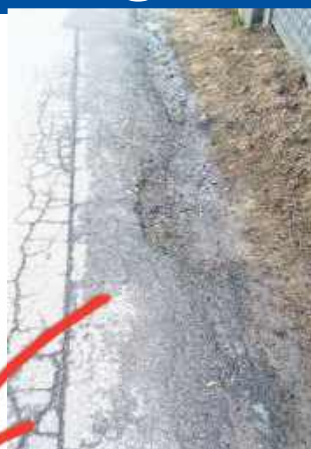
Ul. Spokojna, Przy poboczach są nadżerki
