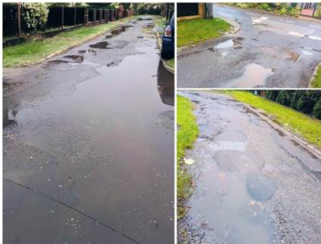
Tak wygląda nawierzchnia ulicy Ignacego Kraszewskiego w Chełmie po opadach deszczu. Liczne ubytki w jezdni wypełniają się wodą, przez co trudno ocenić ich głębokość. Miasto zapowiada doraźne naprawy do 20 listopada, a kompleksową przebudowę ulicy planuje na 2027 rok.
